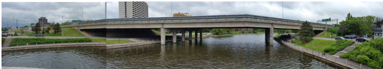
Pont du canal Rideau : vue à partir du pont Pretoria Canal Rideau – lieu historique national et site du patrimoine mondial de l'UNESCO
